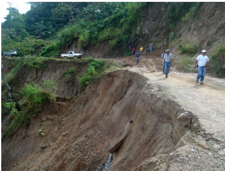
Erosion bei Lampocoy
