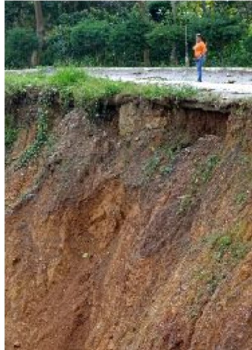
Milvia am Abgrund, Asphalt unterspült
