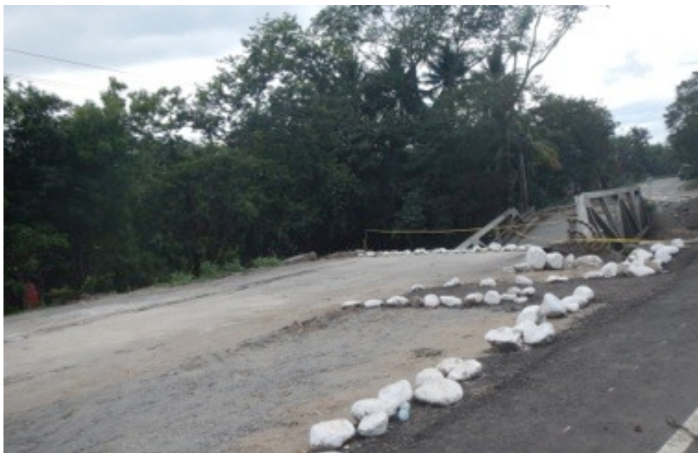
Vollsperrung - eingestürzte Brücke bei Gualán
