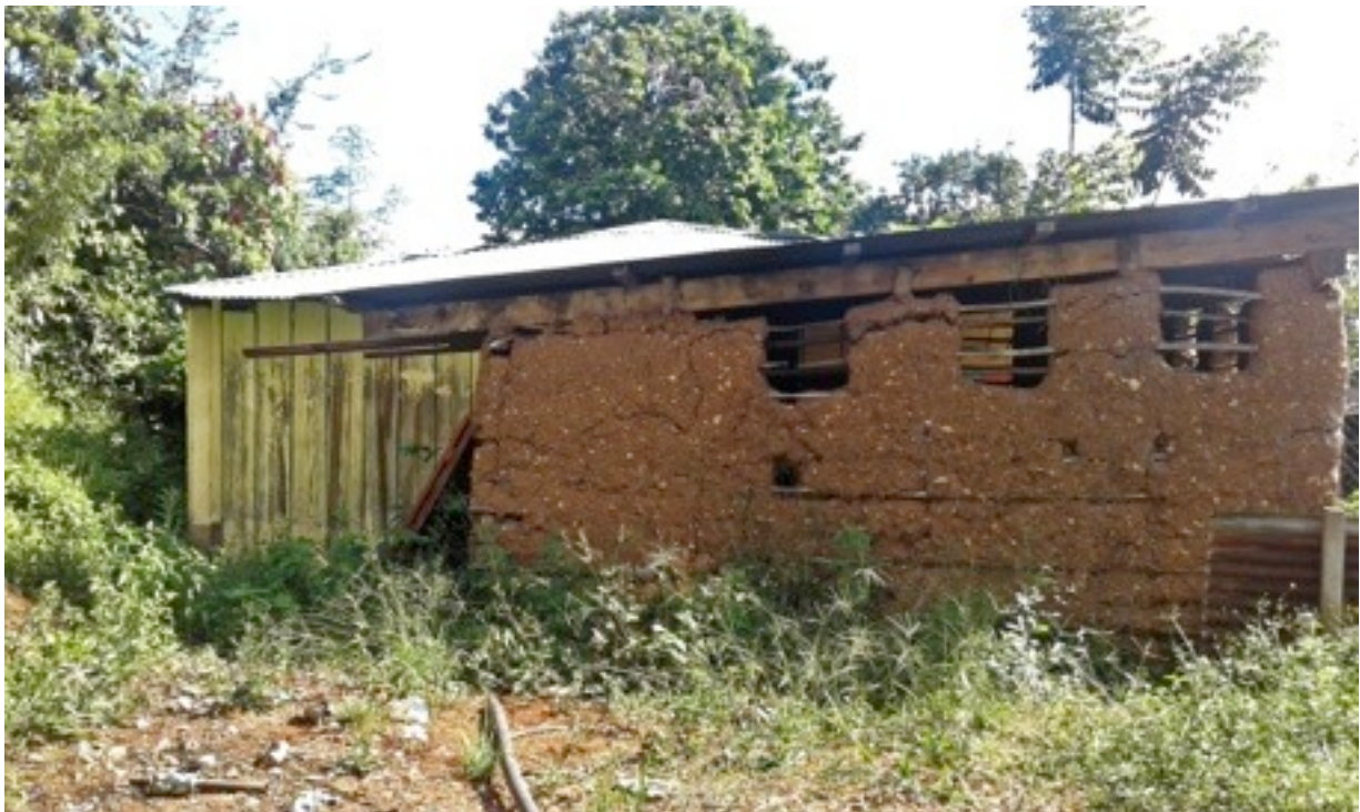
Das völlig verfallene Schulgebäude für die Vorschulkinder
