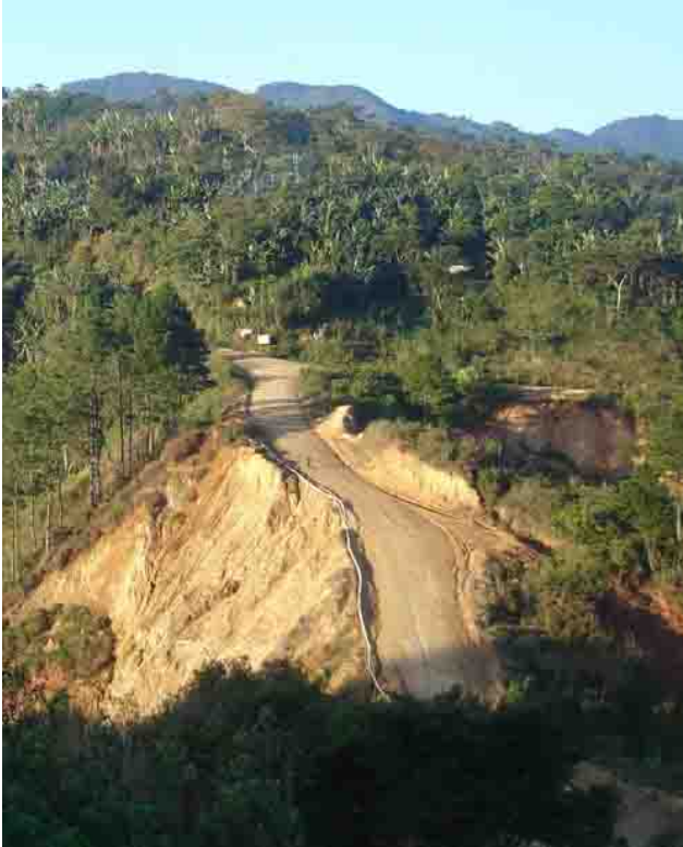
Erosion an der Strasse nach Lampocoy
