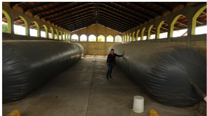
Speicher für das Biogas aus der Kläranlage
