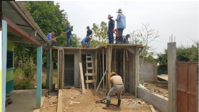
Sanitäre Anlagen für die Vorschulkinder in Capucalito
